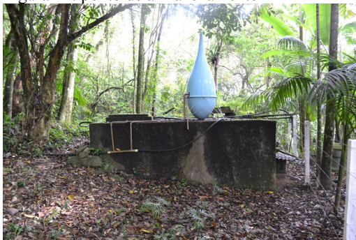
Figura 22: ponto de armazenamento A
