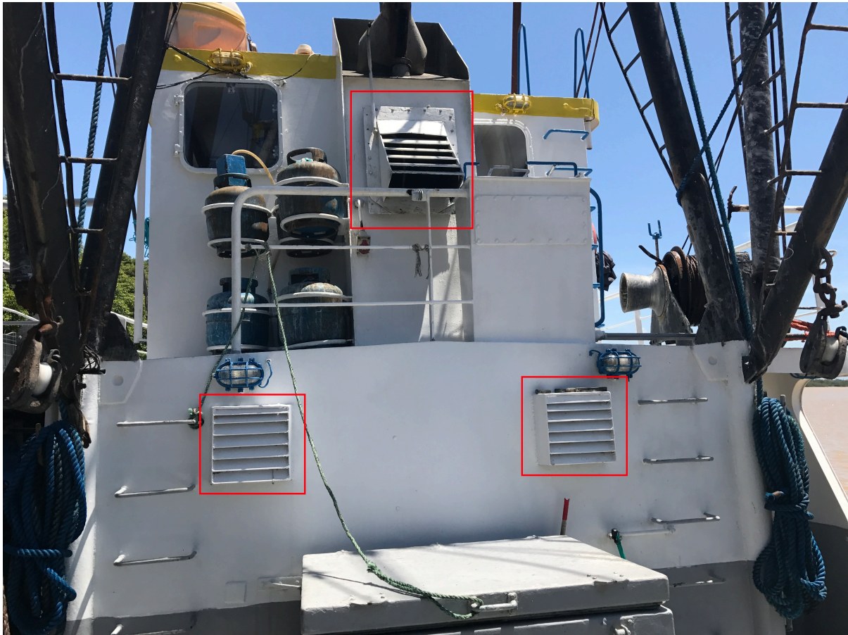
Figura 26 - Saídas de ar da sala de máquinas
