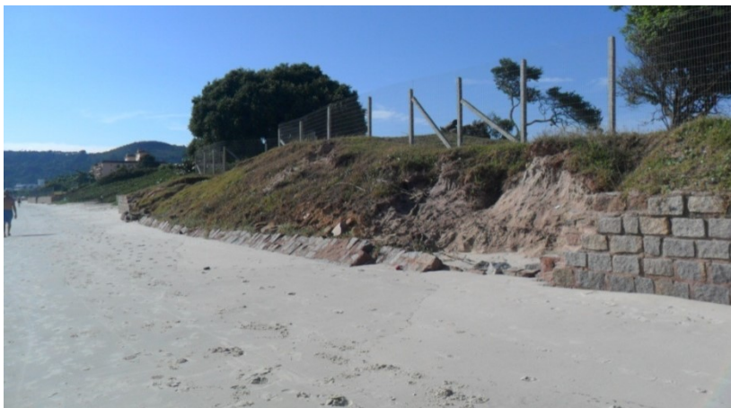
Figura 54. Erosão em muro divisor de propriedade particular (Foto de Mayara Moreira da Silva, janeiro de 2016).
