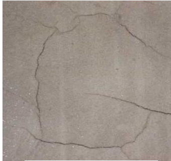
Figura 14 - Fissuração em mapa
