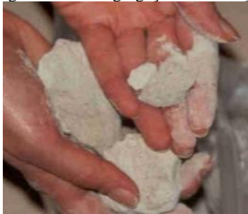
Figura 16 - Desagregação do emboço
