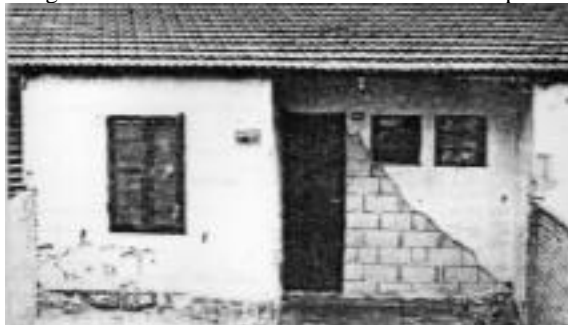
Figura 17 - Deslocamento devido à falta de chapisco
