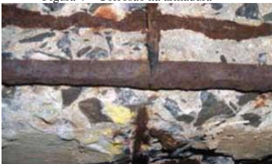
Figura 4 – Corrosão na armadura
