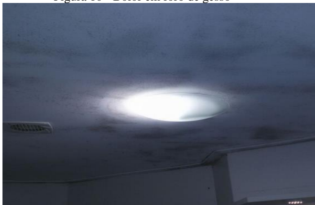
Figura 10 - Bolor em foro de gesso
