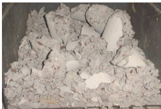
Figura 3.5: Spalling do concreto Fonte: LIMA (2005)
