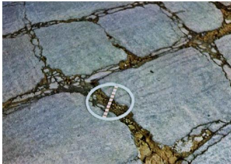
Figura 07 – Trinca Tipo Bloco
