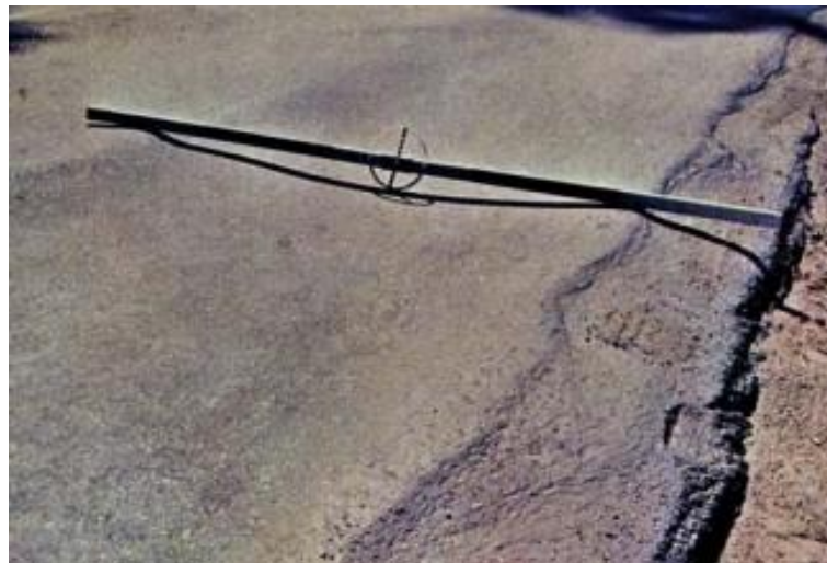
Figura 10 – Afundamento de Trilha de Roda
