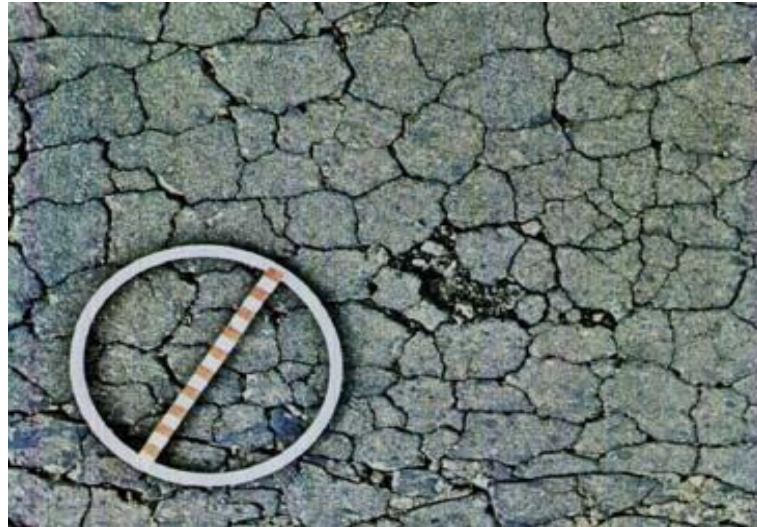
Figura 08 – Trinca Tipo Couro de Jacaré
