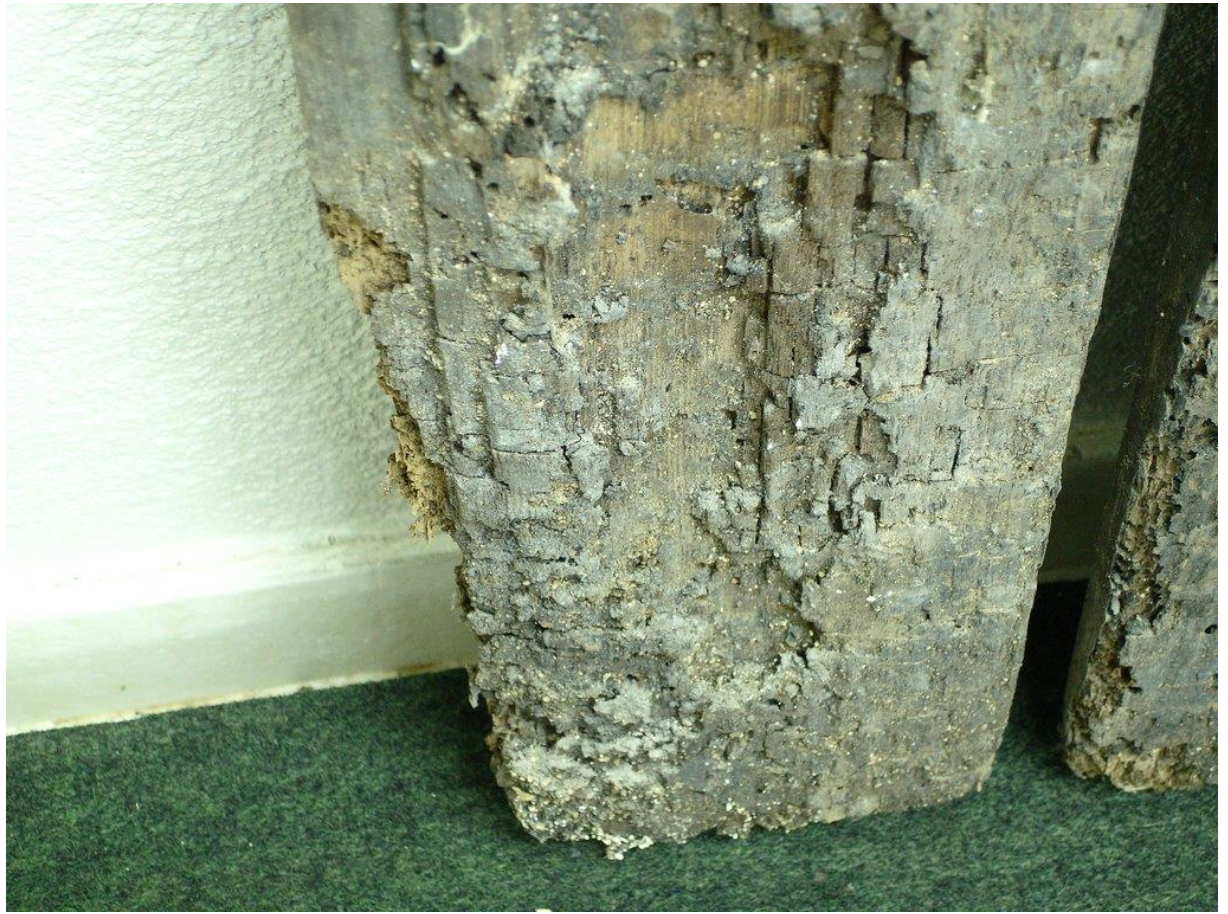
Figura 31 - Madeira parcialmente deteriorada por mecanismo fúngico
