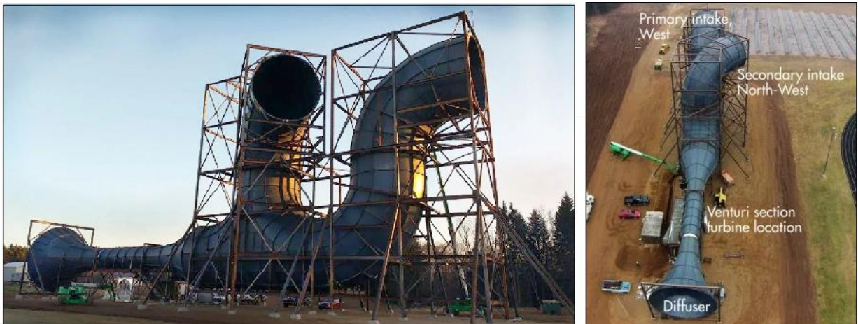
Figura 36 – Sistema 1 SheerWind INVELOX instalado na Guarda Nacional do Exército em Michigan
