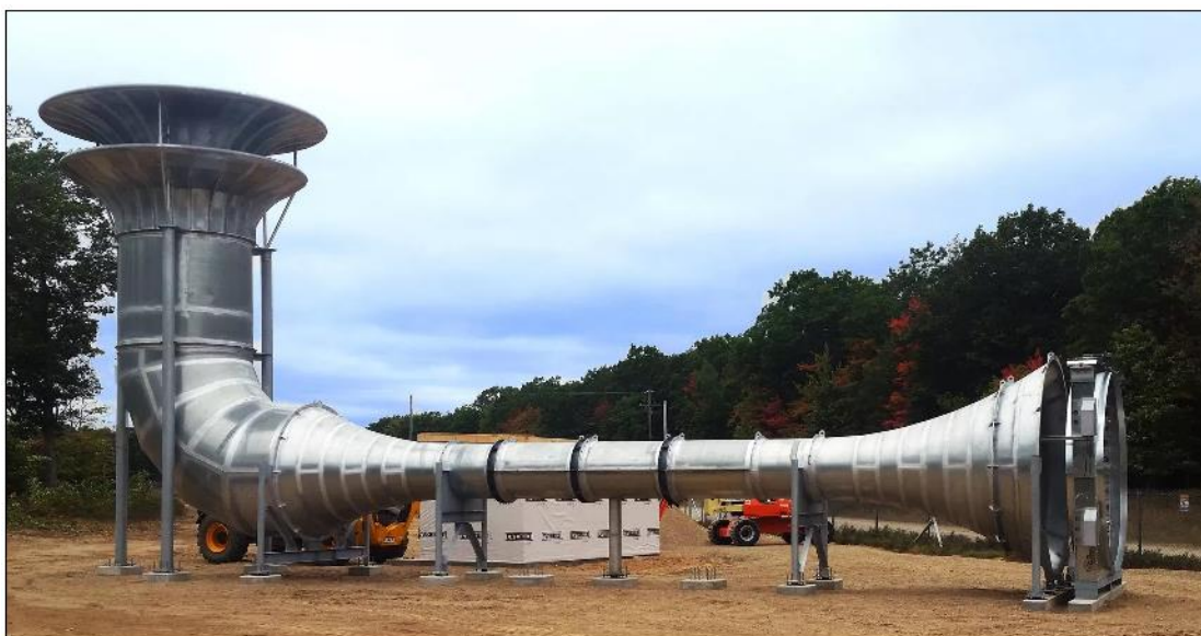
Figura 37 - Sistema 2 SheerWind INVELOX instalado na Guarda Nacional do Exército em Michigan
