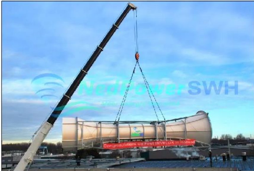
Figura 34 – 200KW instalado na Holanda
