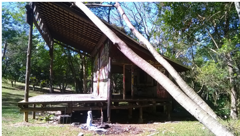
Figura 8. Queda de árvores comprometendo a estrutura do palco.
