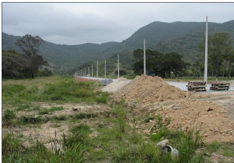
Figura 18 – Loteamento em fase de obras localizado na área de estudo no Ribeirão da Ilha, Florianópolis, SC.
