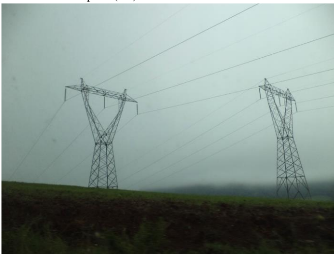
Imagem 9 - Linhas de Transmissão de alta tensão instaladas pela Eletrosul e Celesc dentro da T.I Xaçecó (SC) nos anos 2000.
