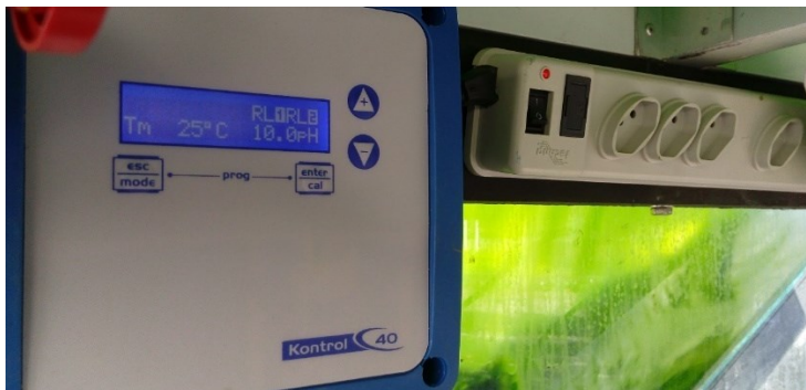
Figura 13 – Monitor e controlador de pH Kontrol 40
