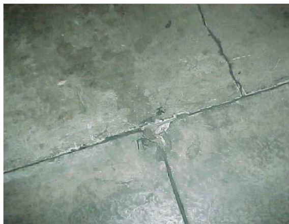
Figura 11- Fissuras de retração por evaporação.
