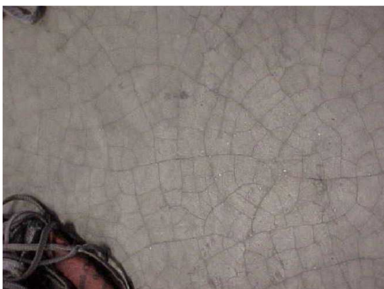
Figura 10 - Fissuras superficiais concentradas.
