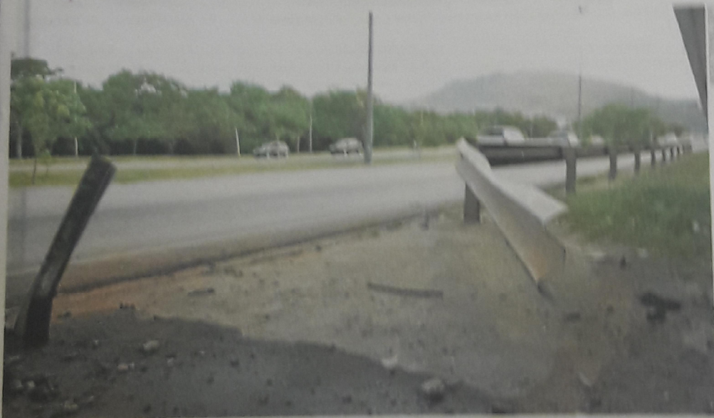
Guardrail na SC-401 aguarda manutenção após o acidente ocorrido na manhã de sábado, que fez duas vítimas fatais.
