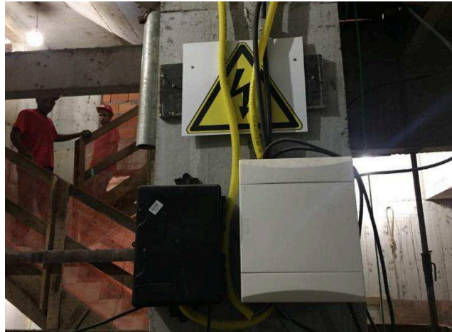
Figura 5 - Proteção da rede elétrica
