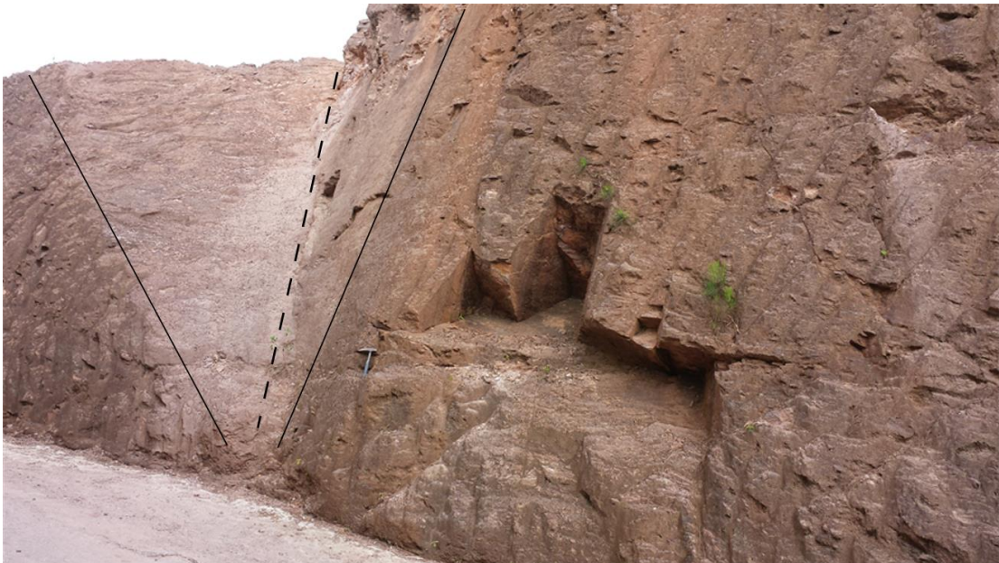
Figura 21. Desprendimento em cunha, causado pelo afloramento da linha de intersecção de dois planos em uma das vertentes artificiais do maciço.
