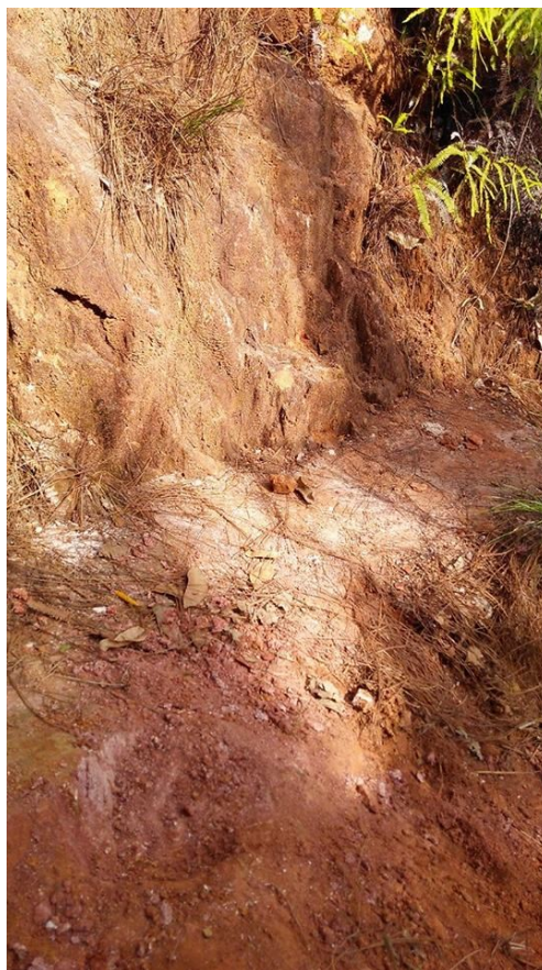
Figura 21 - Talude exposto no terceiro ponto de coleta.
