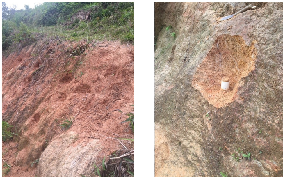
Figura 35 – Disparidade entre os solos ao longo do Talude 4 .
