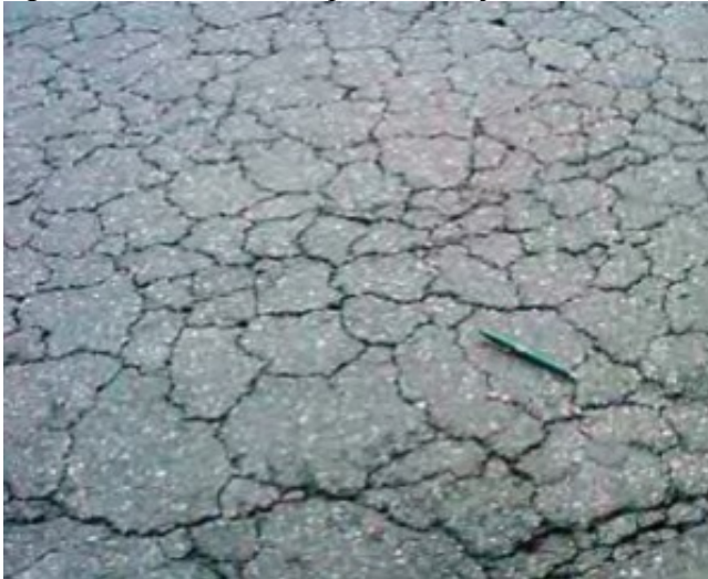
Figura 12 - Trincamento tipo couro de jacaré
