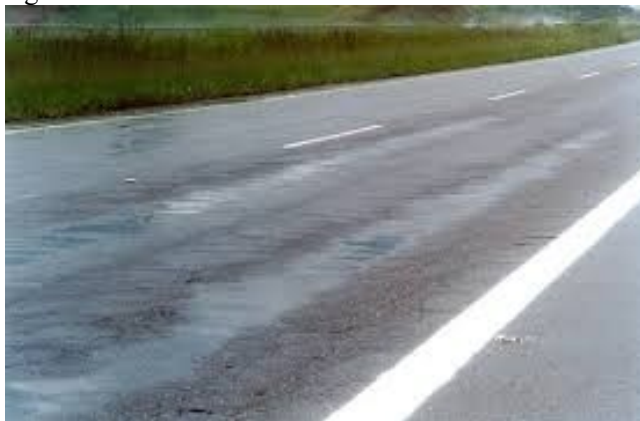
Figura 14 - Afundamento de trilha de rodas
