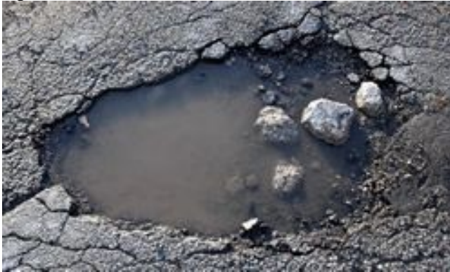
Figura 13 – Panela ou buraco
