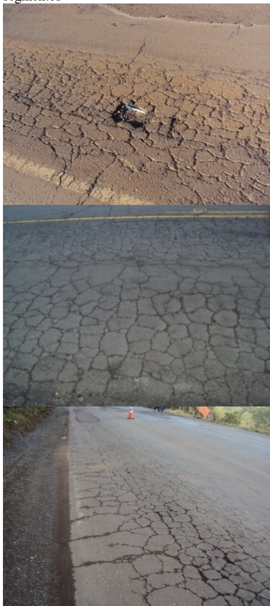
Figura 25 - Principais defeitos encontrados na rodovia na região dos segmentos
