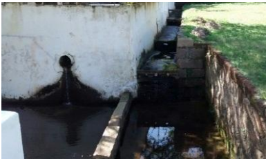
Figura 12: Tubulação ao lado da Fonte da Carioca, água descendo do morro no Centro, Laguna/SC.
