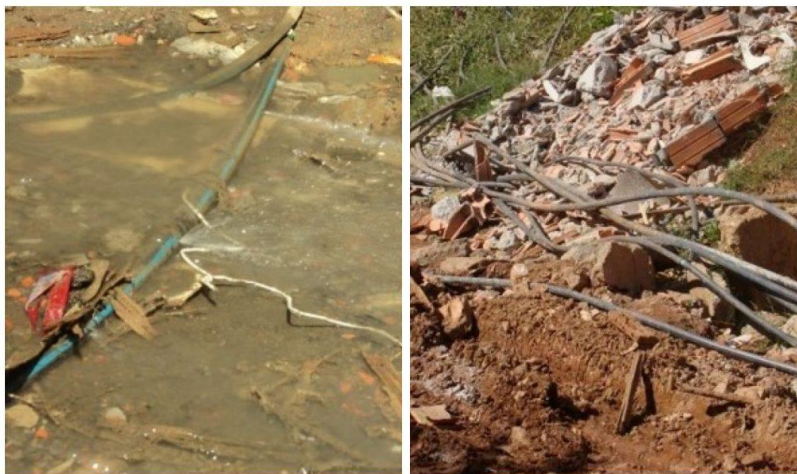
Figura 10 - Exemplos de gambiarras de mangueiras de água
