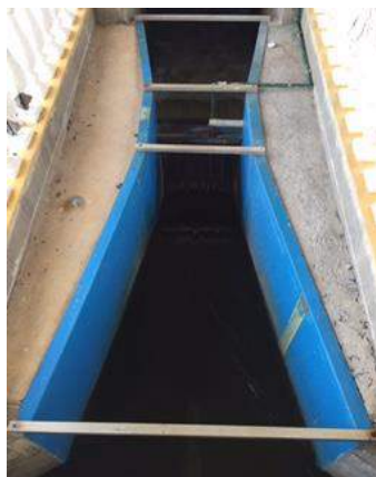
Figura 12: Calha Parshall da estação de tratamento de água da Lagoa do Peri.
