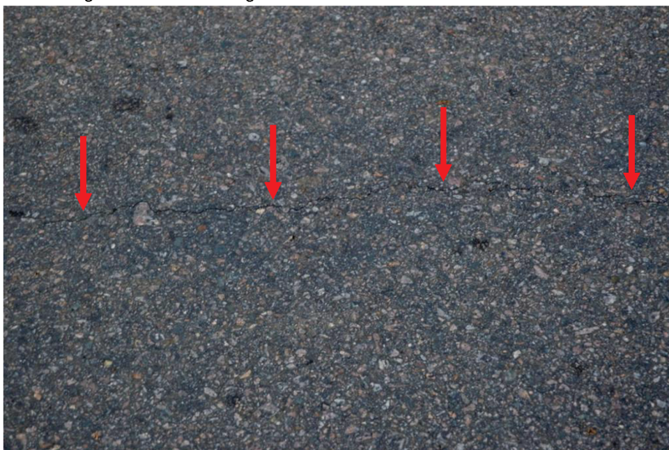
Figura 48 - Trinca longitudinal na faixa Pedras Grandes – Orleans
