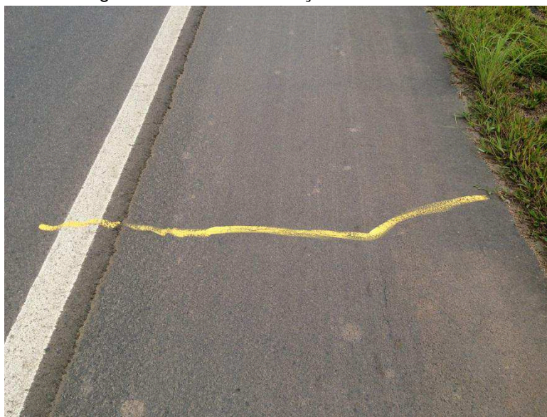
Figura 51 - Trinca de retração no acostamento
