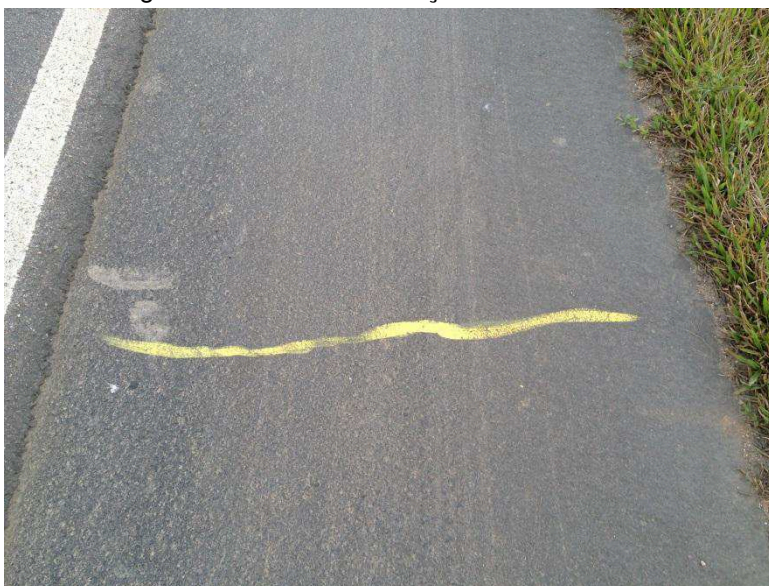
Figura 52 - Trinca de retração no acostamento
