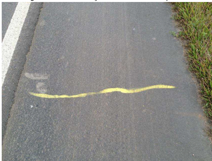
Figura 36 - Demarcação de defeitos de superfície
