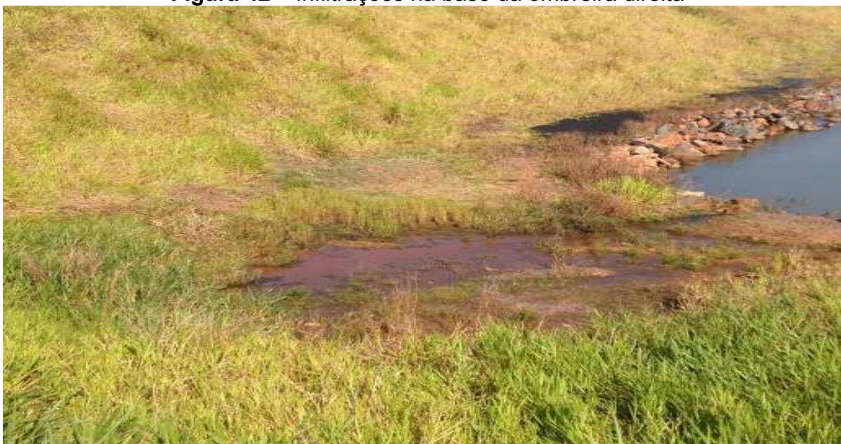
Figura 42 – Infiltrações na base da ombreira direita
