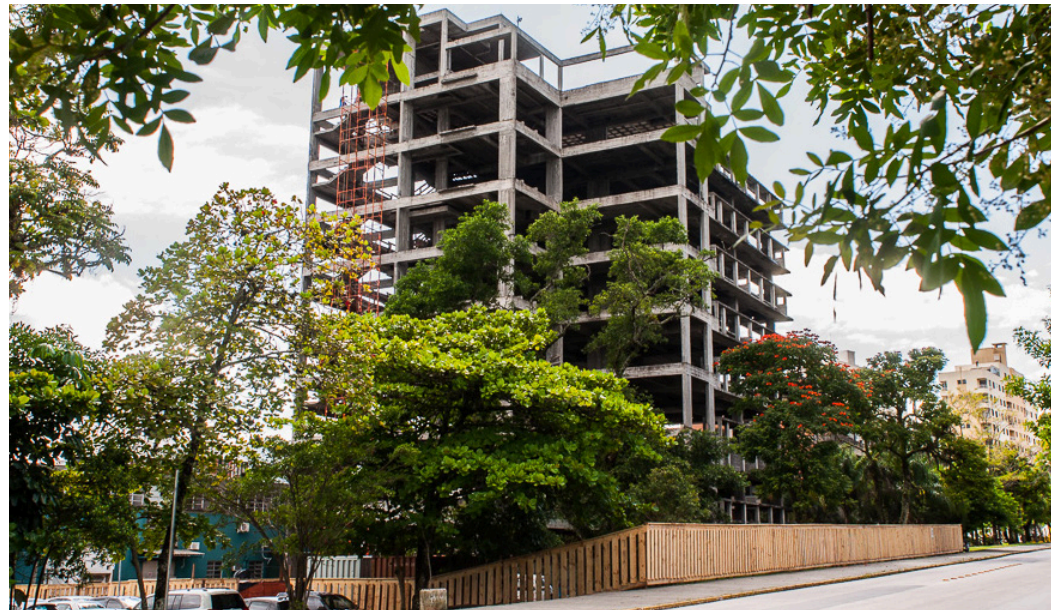
A primeira etapa da obra do prédio do Instituto de Engenharia de Superfícies do Departamento de Engenharia Mecânica do Centro Tecnológico, financiada com recursos CT-INFRA/FINEP e da UFSC foi concluída em janeiro de 2013. A obra foi retomada em março de 2016 e será um dos laboratórios multi-usuários mais bem estruturados do país. Crédito: Jair Quint/Agecom/DGC/UFSC
