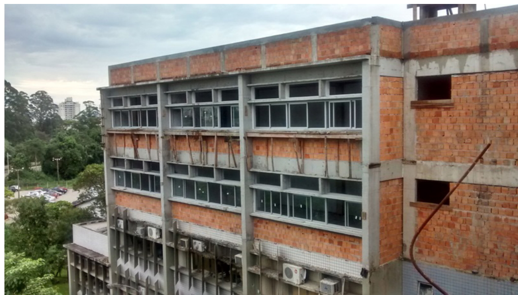
A ampliação dos Blocos A e B e a construção do Bloco de Ligação dos prédios da Engenharia Civil do Centro Tecnológico (CTC) está com quase 50% de sua construção concluída. Crédito: DFO/PROPLAN/UFSC
