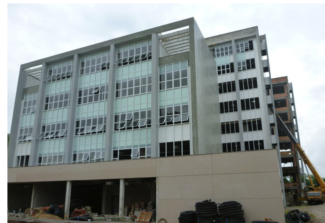
Os novos blocos de Salas de Aula E, F e G e a Subestação de Energia Elétrica para o Centro de Ciências Biológicas (CCB) têm 45% de sua construção concluída. Trata-se da maior obra em andamento na UFSC, com área de 13.080,70 m 2 e valor de mais de R$ 45 milhões. Crédito: DFO/PROPLAN/UFSC
