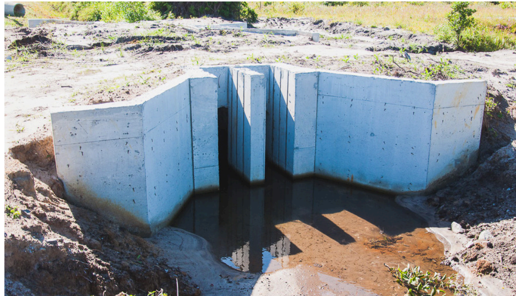
O novo sistema de Manejo de Águas da Fazenda Ressacada é de grande importância para as atividades desenvolvidas tanto com lavouras como no trato com os animais. Com o sistema de drenagens é possível controlar a altura da água no solo e a hidratação do solo ideal para pastos e lavouras. Crédito: Pipo Quint/Agecom/DGC/UFSC
