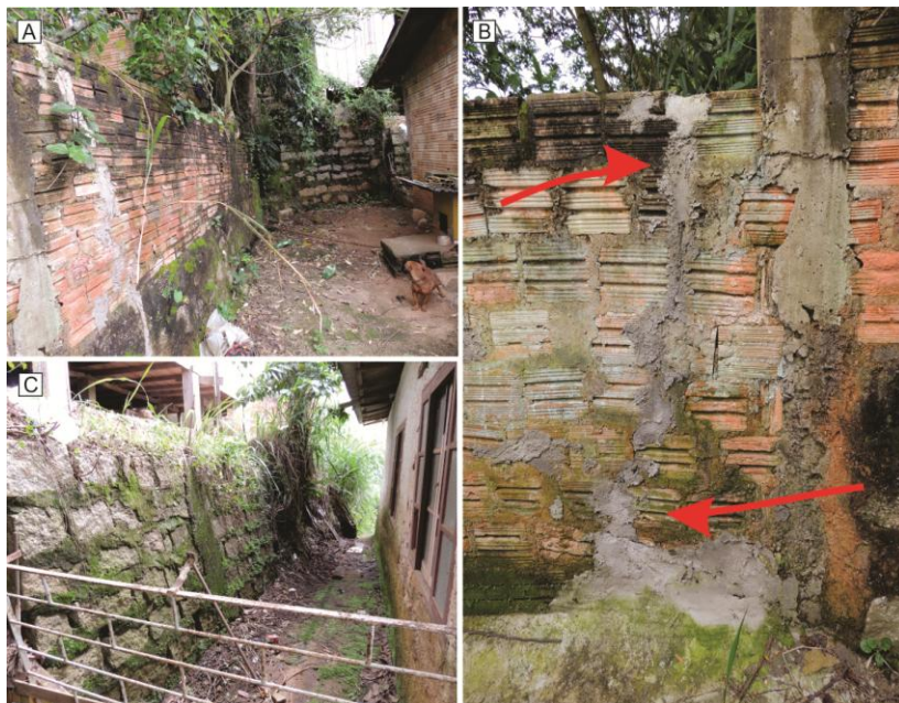
Figura 72: (a) vista da parte lateral do terreno; (b) Fissuras recém preenchidas pelo morador, impossibilitando ver o espaço entre os tijolos; (c) vista da parte detrás da casa.
