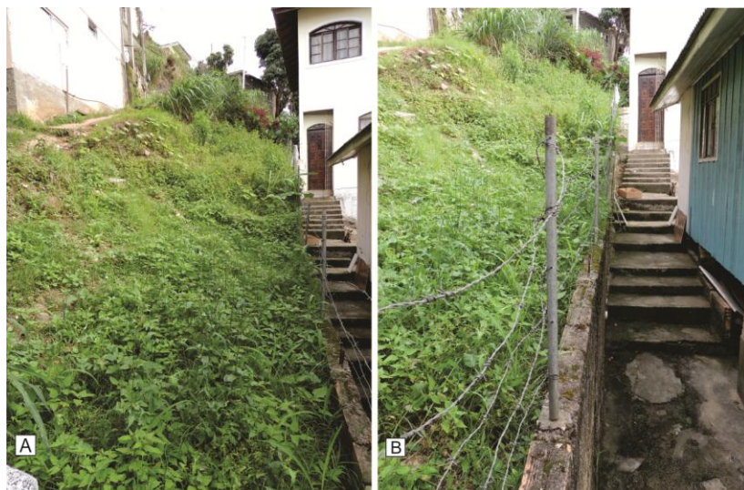
Figura 79: (a) Vista da encosta; (b) vista do muro que contém a encosta.
