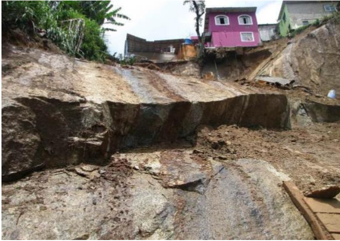
Figura 34: Vista de um talude onde a parte mais baixa já deslocou e a parte acima não deslocou.
