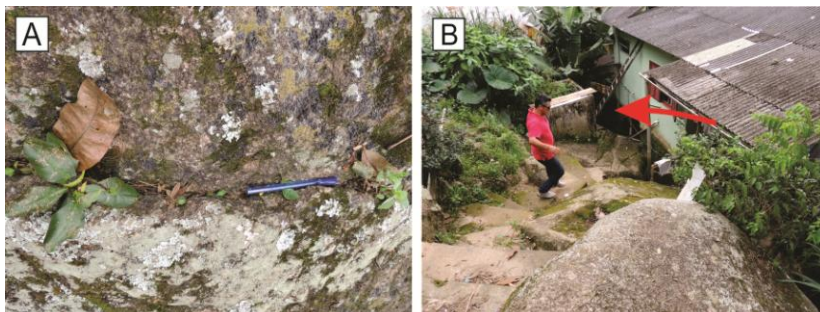
Figura 58: (a) Visíveis deslocamentos do bloco granítico rochoso; (b) indicação de drenagem passando embaixo da moradia.
