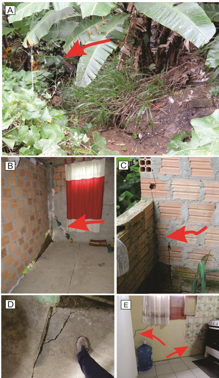
Figura 62: (a) Vista geral da parte abaixo da moradia; (b), (c), (d), (e) fissuras encontradas nas paredes e no chão da moradia.
