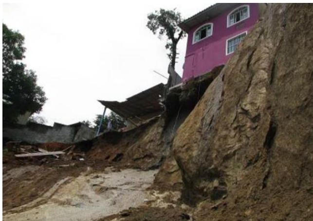
Figura 39: Vista de um descalçamento de sapatas de algumas edificações.
