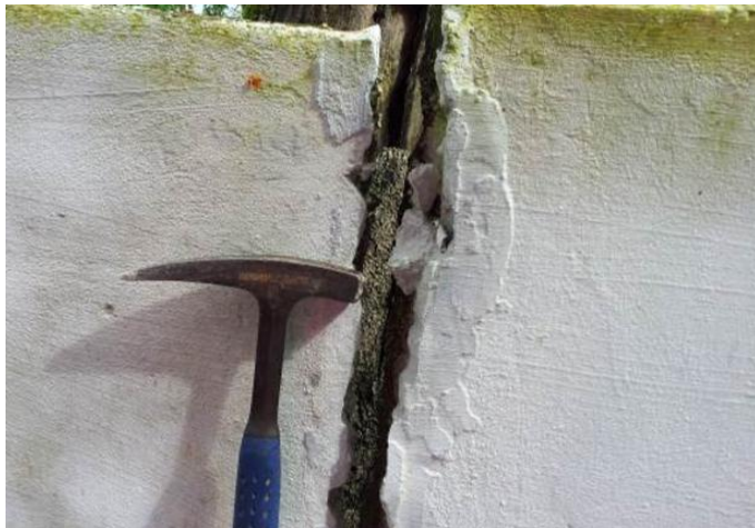
Figura 42: Vista de uma grande fissura em um muro próximo ao deslizamento.
