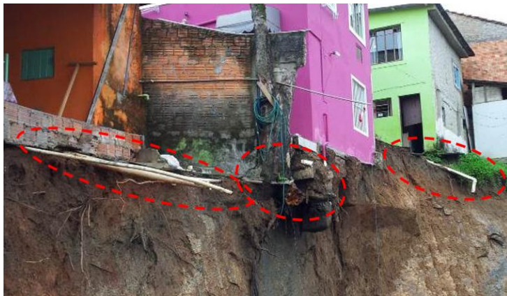
Figura 38: Área a montante do deslizamento com zonas saturadas por águas pluviais e águas servidas.
