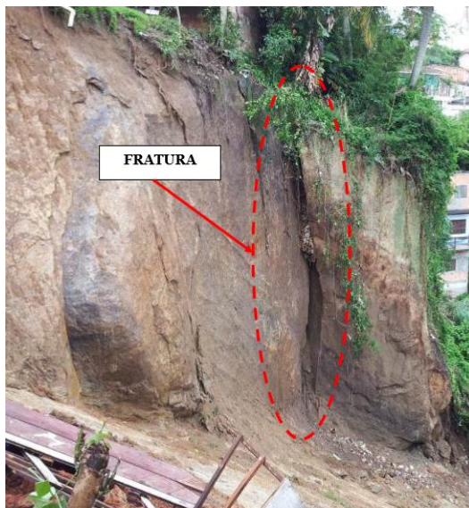
Figura 32: Fratura aberta com aproximadamente 3m de altura.
