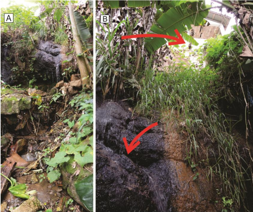
Figura 61: (a) visão da drenagem abaixo da residência; (b) indicação de indícios de deslocamentos da rocha e da moradia do terreno.
