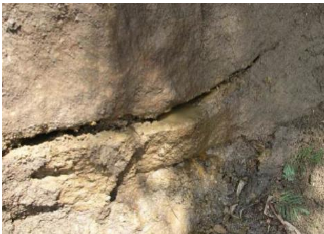
Figura 31: Água saindo de uma fratura.
