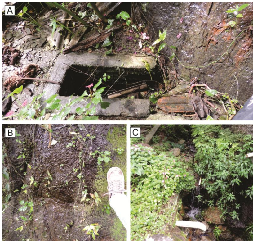
Figura 50: (a) ambiente muito úmido atrás da casa; (b) drenagem passando na face de um dos blocos; (c) drenagem de médio porte que passa na lateral do terreno.
