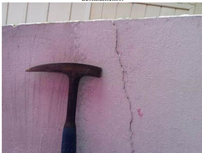
Figura 43: Vista de uma pequena fissura em um muro próximo ao deslizamento.
