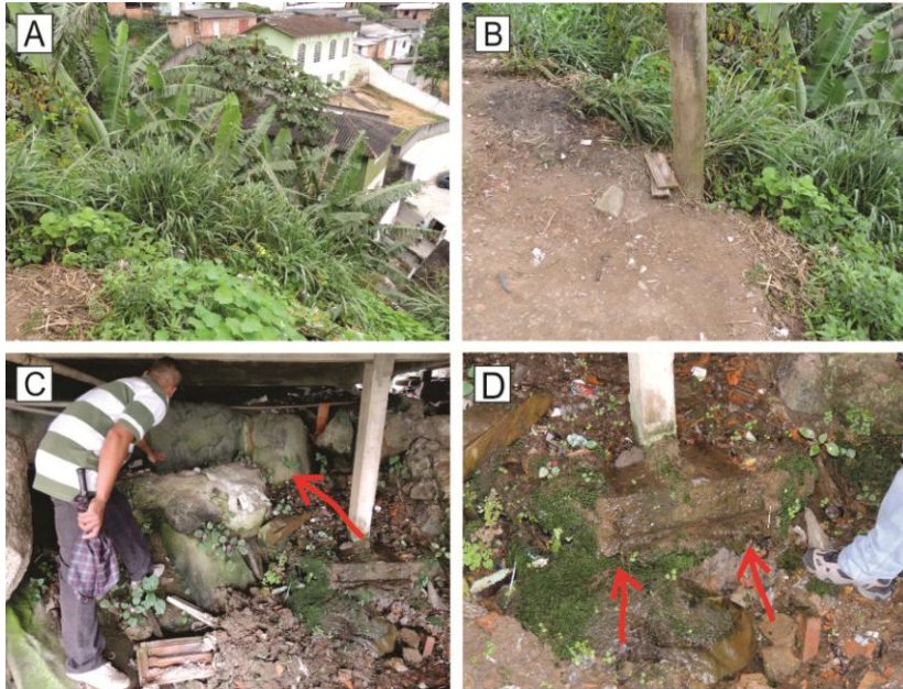
Figura 51: (a) Vista da parte da encosta em frente à casa; (b) vista do muro quase sem sustentação, evidenciando sinais de movimentação; (c) abaixo da moradia é visto dique de riolito (indicado na foto) e blocos de granitoides; (d) sapatas estão perdendo a sustentação sob influência da drenagem.
