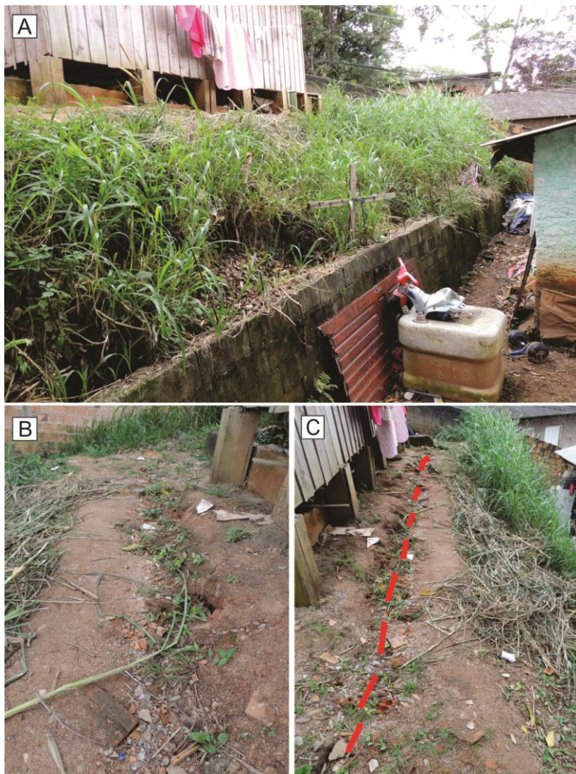
Figura 67: (a) Vista da parte da frente da casa; (b) fissuras na encosta; (c) a linha tracejada mostra a fissura que atravessa perpendicularmente a encosta.
