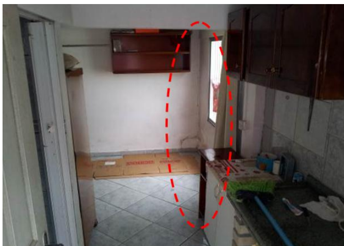
Figura 41: Vista de uma casa com uma parede rompida.
