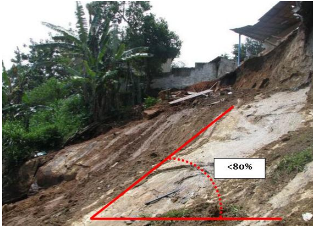
Figura 30: Fraturas com inclinação menor que 80%.
