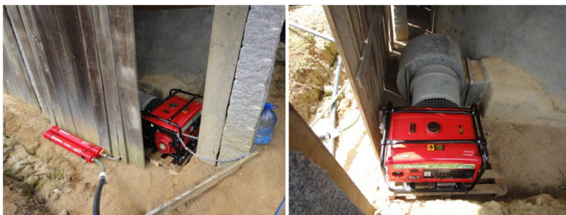
Figura 20. Motogerador. Fonte: Arquivo TSGA.
