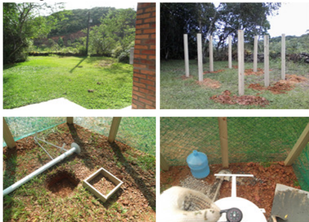
Figura 53. Imagem da infraestrutura necessária para instalação da estação pluviométrica.
