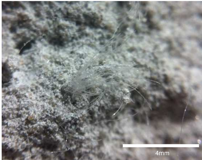
Figura 31: Acúmulo de Fb no interior das argamassas
