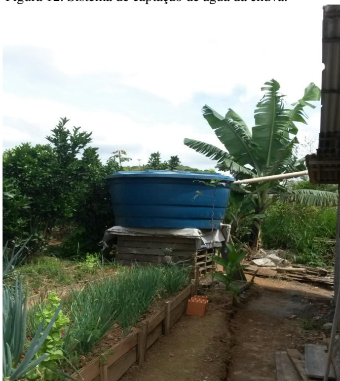
Figura 12. Sistema de captação de água da chuva.
