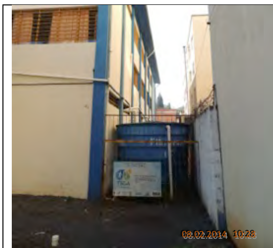
Imagem 56 - Cisterna Instalada na Escola Educação Básica Deodoro durante TSGA I.
