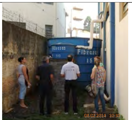
Imagem 57 - Cisterna Instalada na Escola Educação Básica Deodoro durante TSGA I.
