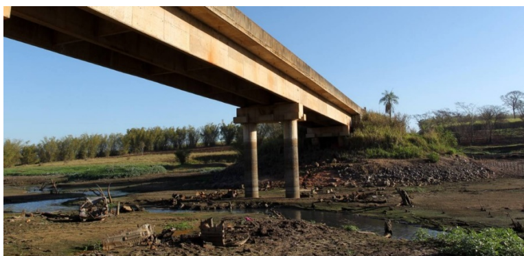
Caminho seco. As marcas nos pilares da ponte mostram o nível do rio antes da seca que castiga o interior paulista. O transporte hidroviário está parado há dois meses. (Foto de Marcos Alves)
