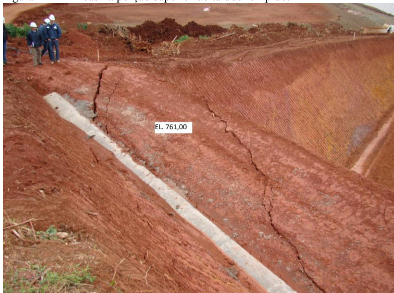
Figura 12 – Trincas na porção superior do talude rompido.
