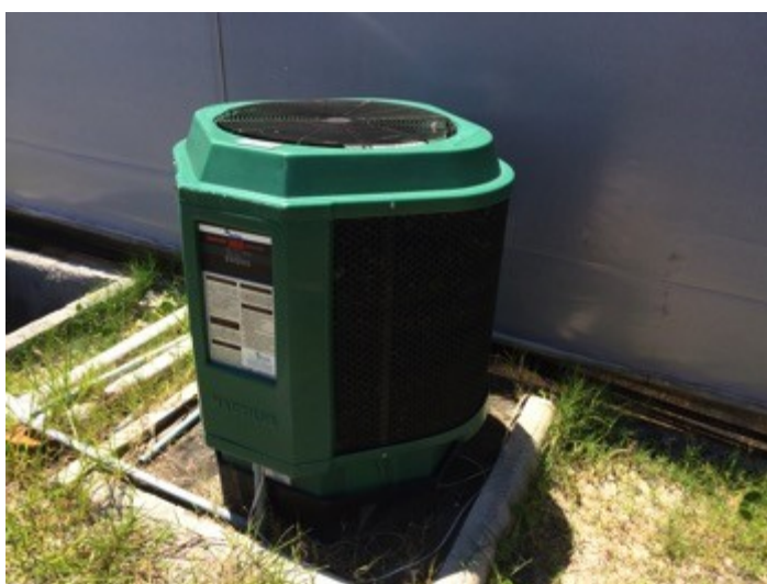
Figura 8 - Trocador de calor, localizado fora da estufa.
