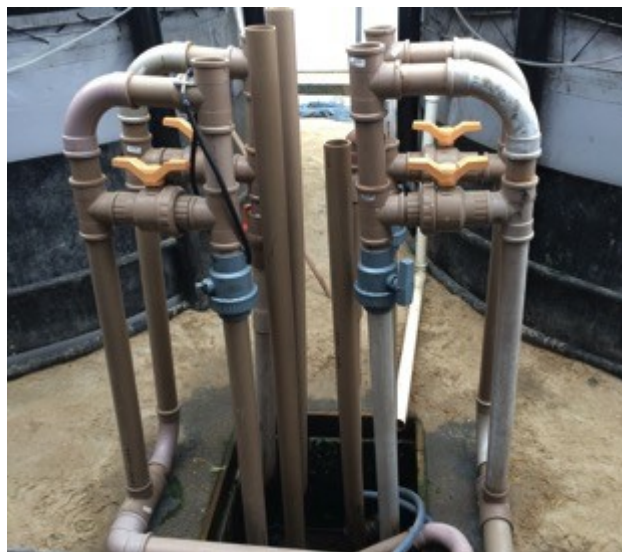
Figura 5 - Sistema 'árvore' de controle de nível dos tanques.
