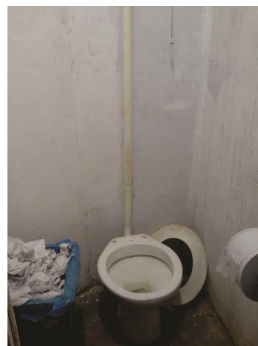
C- Box do vaso sanitário. Local: estudo B e C.
