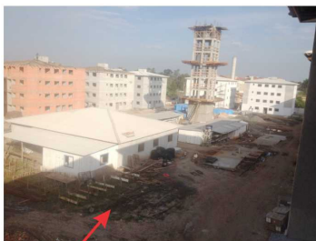
A- Central de armaduras com parte das atividades executadas a céu aberto, sem banco de apoio e extintor. Local: estudo A .
