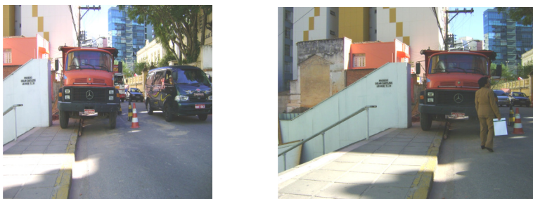
Figura 1- À esquerda, apropriação da via pela obra. À direita, obstrução do passeio. Fonte: autora, 2007.
