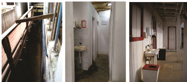
A- Águas acumuladas no canteiro ( pluvial misturada com águas servidas).Local:estudo C.
