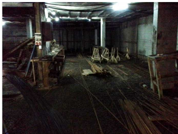
B- Central de armaduras no pavimento subsolo com baixa iluminação e ventilação. Local: estudo C .
