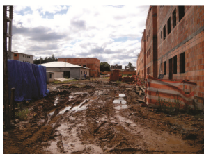
A- Área de circulação do canteiro, sem delimitação de fluxo de veículos e de pessoas. Condição do piso complicando o acesso seguro. Local: estudo A .
