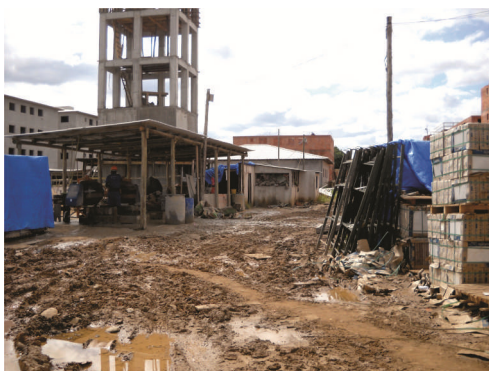
A- Central de argamassas e concreto no estudo de caso A.
