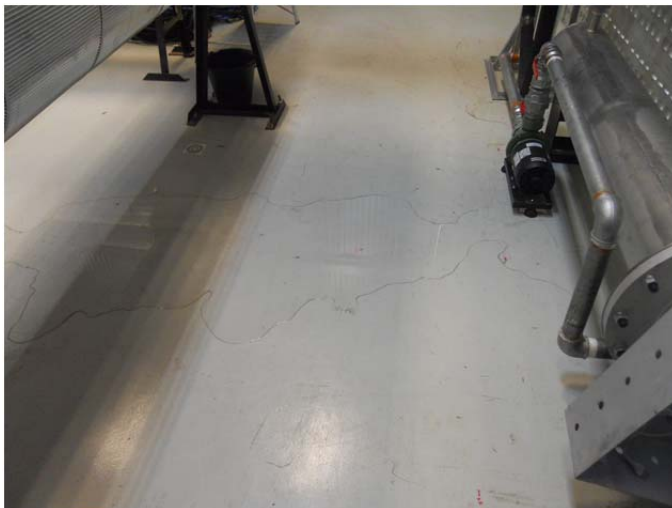
Figura 57 – Vazamento apresentado no aquecedor de 200 KW (B)
