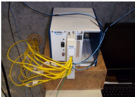
Figura 69 – Sistema de aquisição de dados da NATIONAL INSTRUMENTS com Modulo NI SCXI-1000 e terminal NI SCXI-1303.
