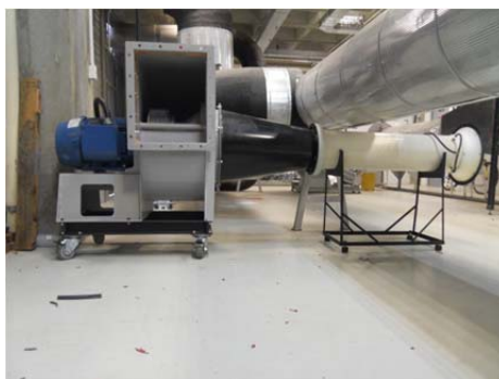
Figura 46– Ventilador acoplado a todos os elementos instalados na sucção
