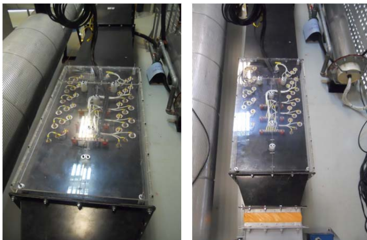
Figura 74 – Instalação elétrica no banco de resistência para o sistema de ar
