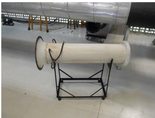
Figura 45 - Anel de pressão instalado no duto de sucção (B)
