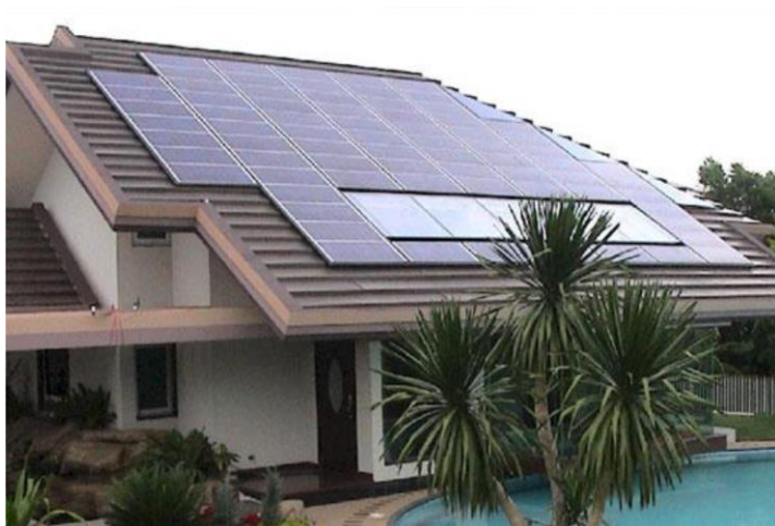
Figura 57 - Coletores solares para aquecimento de água, inseridos entre módulos fotovoltaicos.
