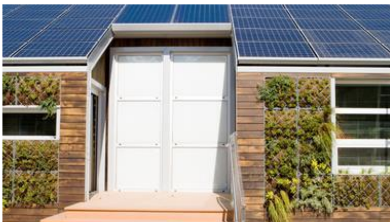
Figura 58 - Coletores solares fotovoltaicos e para aquecimento de água servindo como cobertura em uma residência.
