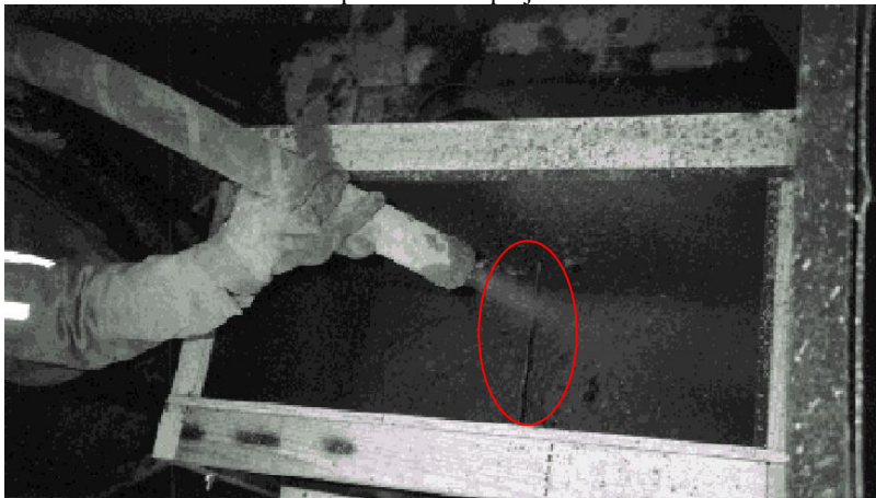
Figura 11 – Detalhe dos termopares (mostrados dentro do contorno em vermelho) sendo envolvidos pelo concreto projetado fresco
