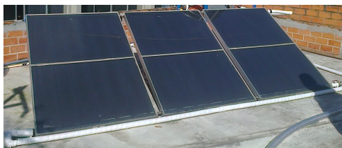
Figura 10 – Foto das placas solares utilizadas para aquecer a água
