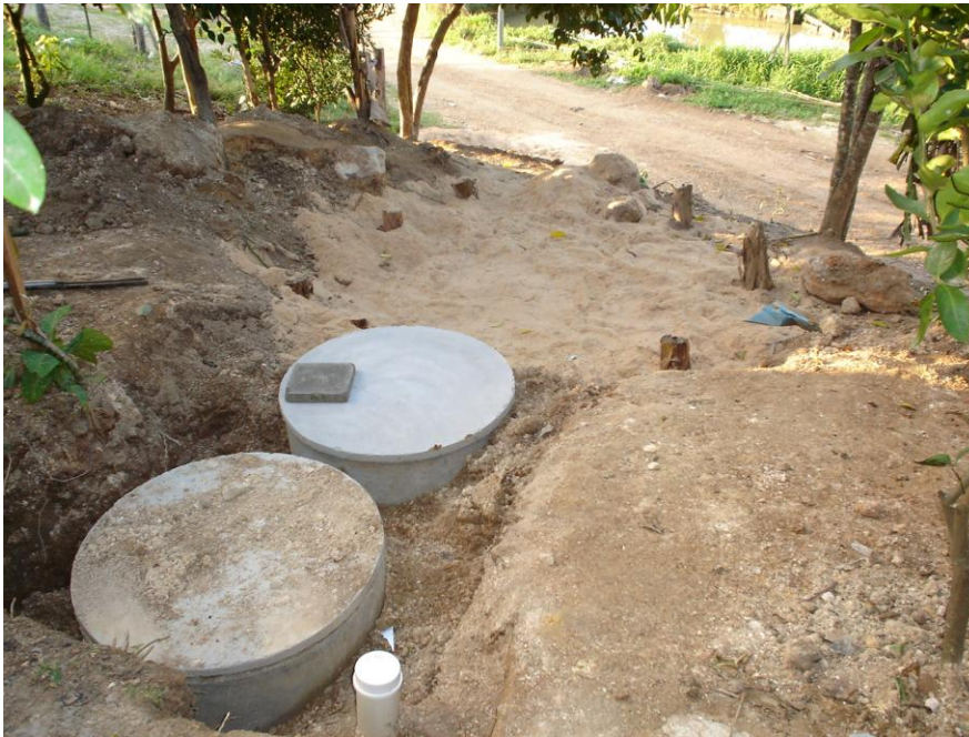
Figura 15. Instalação do Reator Unicamp duplo
