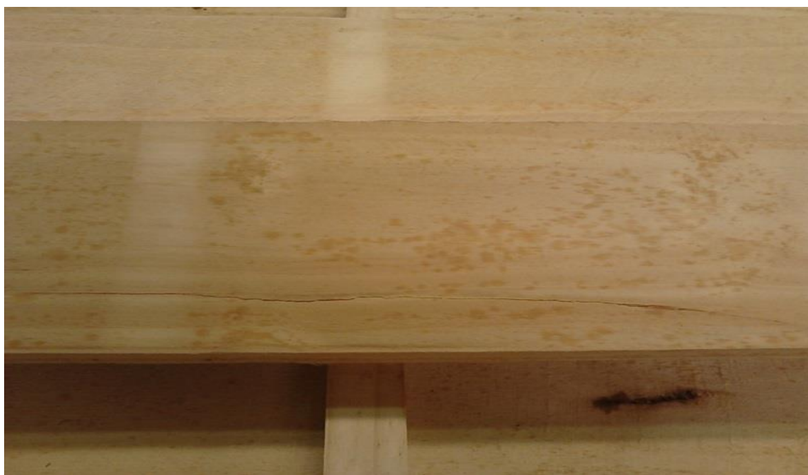
Figura 4. Trinca de superfície ocasionada pela secagem.
