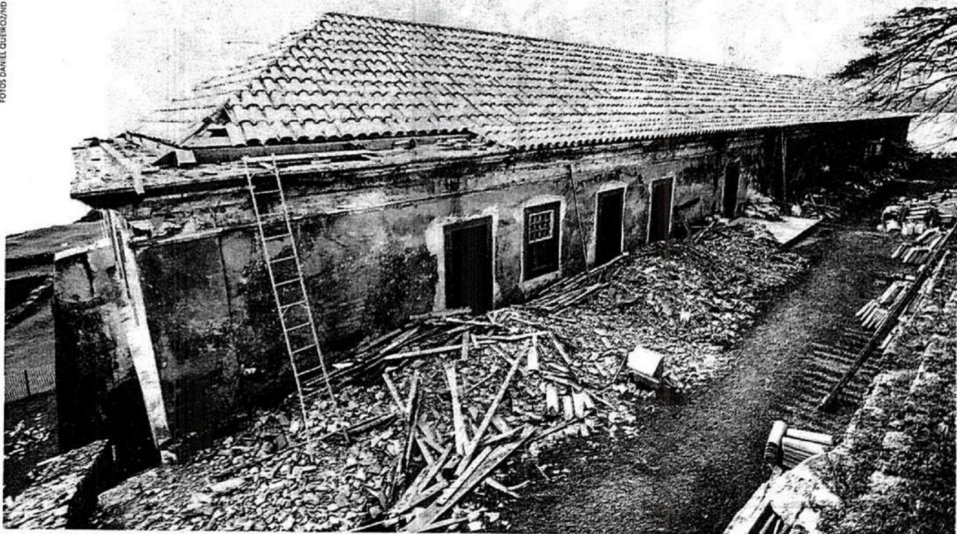
Restauração. Desde setembro de 2013, a UFSC realiza obras emergenciais na fortaleza de Santa Cruz, na ilha de Anhatomirim, com recuperação de paredes e telhados e também pintura
