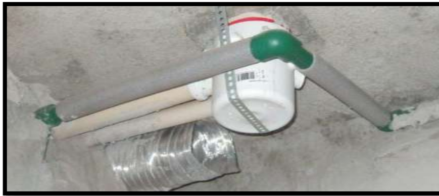
Figura 27 Isolamento da tubulação de água quente
