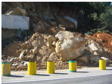
a) deslizamento no corte no Km 316+000
