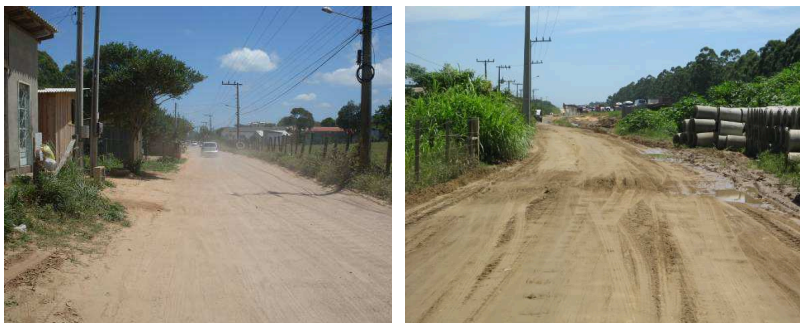
Figura 14 - Km 309+500 - Falta de umidificação da marginal direita da rodovia BR-101.
