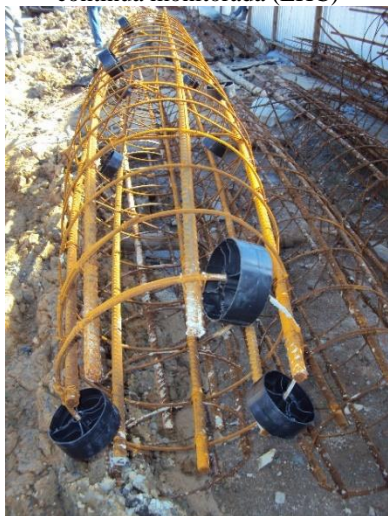
Figura 34 - Detalhe da armadura e espaçadores de uma estaca tipo hélice contínua monitorada (EHC)
