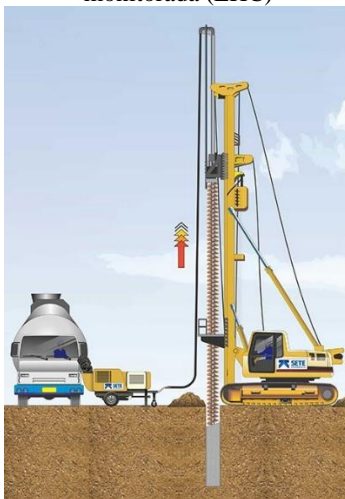
Figura 28 - Etapa de concretagem do fuste da estaca tipo hélice contínua monitorada (EHC)
