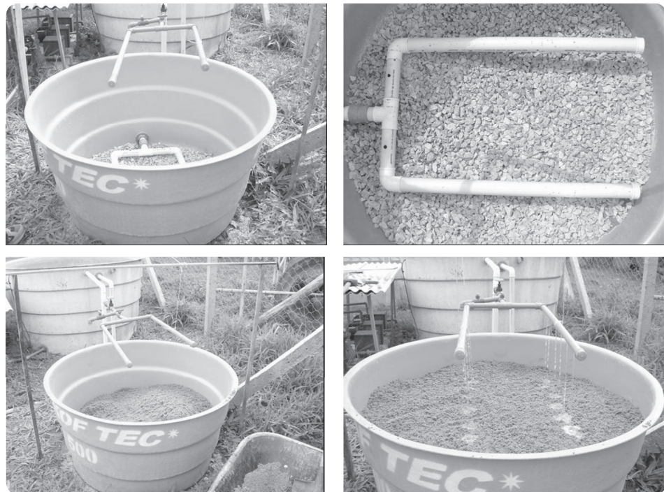
Figura 24: Fotos ilustrativas das etapas de construção de um filtro de areia em um reator de fibra (Acervo GESAD/ENS-UFSC).
