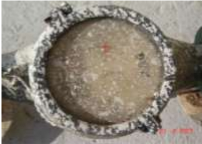
Figura 3: hidrômetro sem condições de leitura
