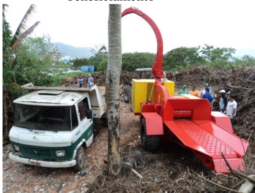
Figura 38: Posicionamento dos equipamentos durante o beneficiamento
