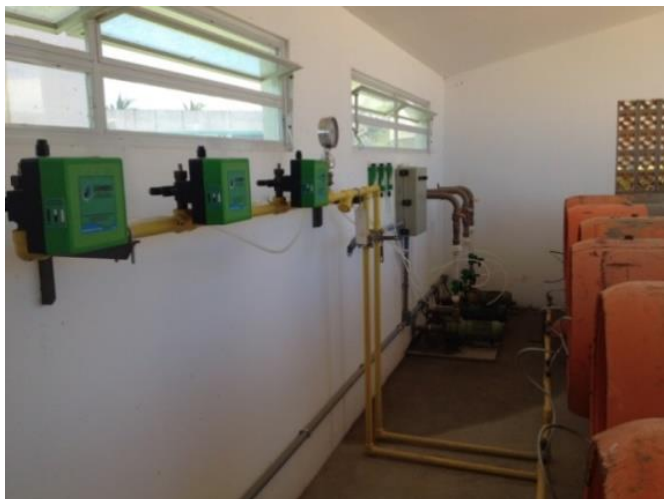
Figura 14 - Detalhe dos Cloradores. Fonte: Elaborado pelo autor.
