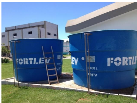
Figura 15 – Caixas d'água de armazenamento de água de serviço. Fonte: Elaborado pelo autor.
