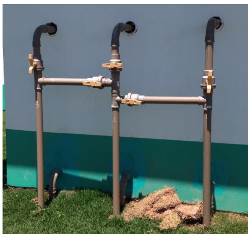
Figura 17 – Canalização a qual encaminha o agente desinfetante para os decantadores. Fonte: Elaborado pelo autor.
