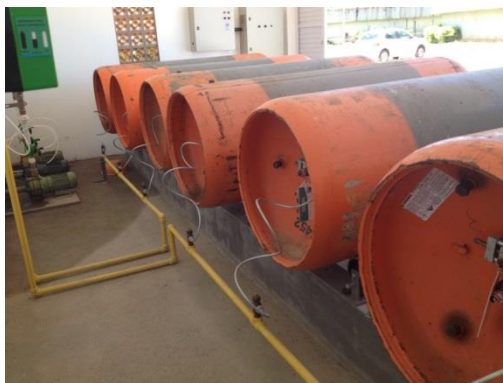
Figura 13– Cilindros de cloro gás. Fonte: Elaborado pelo autor.
