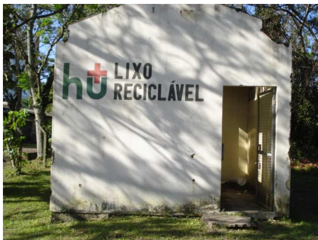
Figura 27 – Abrigo de Resíduo Reciclável Em Estado Deplorável
