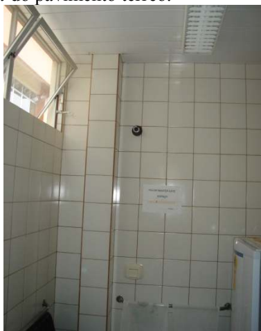
Figura 14- Elementos do banheiro para deficientes físicos não retirados, a saber: válvula de descarga, apoio e registro.
