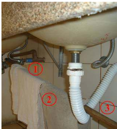
Figura 17- 1: Saída de água para bebedouro; 2: Objetos pendurados na tubulação de esgoto; 3: Sifão fora de padrão.
