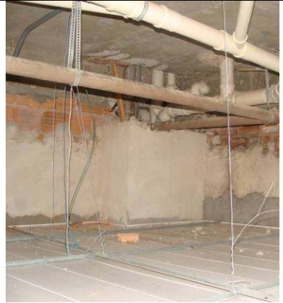
Figura 16- Detalhe das tubulações no forro do banheiro do pavimento térreo.
