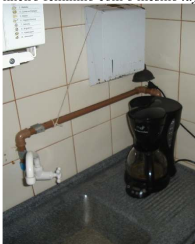
Figura 13- Copa do terceiro pavimento. Instalação de água fria utilizada para alimentação da pia.
