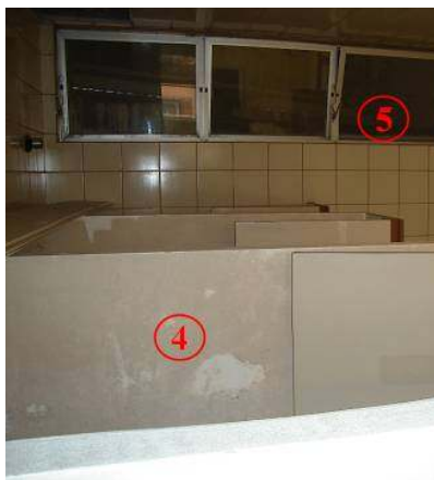
Figura 18- 4: Paredes sem a devida manutenção; 5: Janelas que tiram a privacidade dos usuários dos banheiros.
